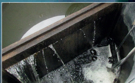
Läckande munk. Vid högvatten flyter sättbrädorna upp. När vattnet sjunker blir munken otät.
